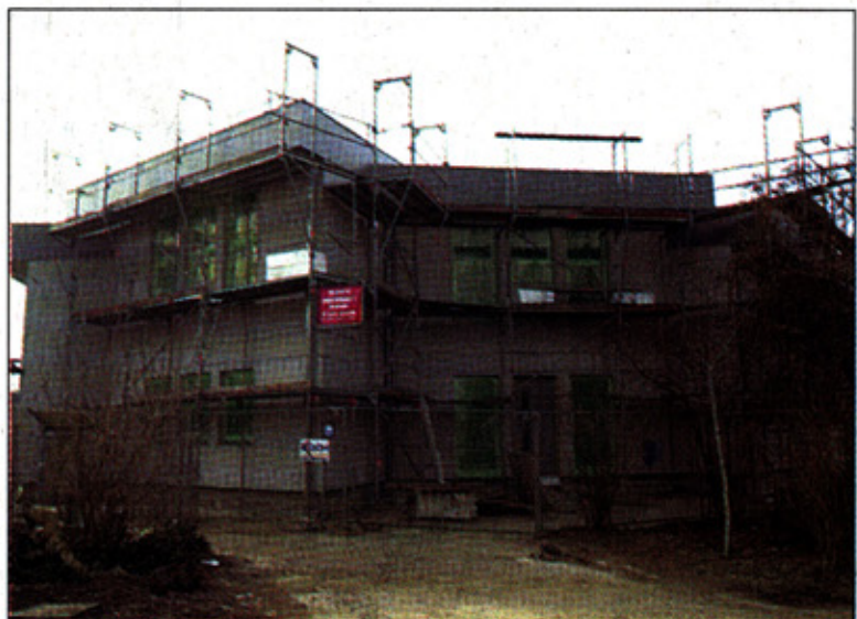
Wegen der Insolvenz des Generalunternehmers ruht der Bau des „FlorAtriums“ seit geraumer Zeit. Foto: Vorderbrück
